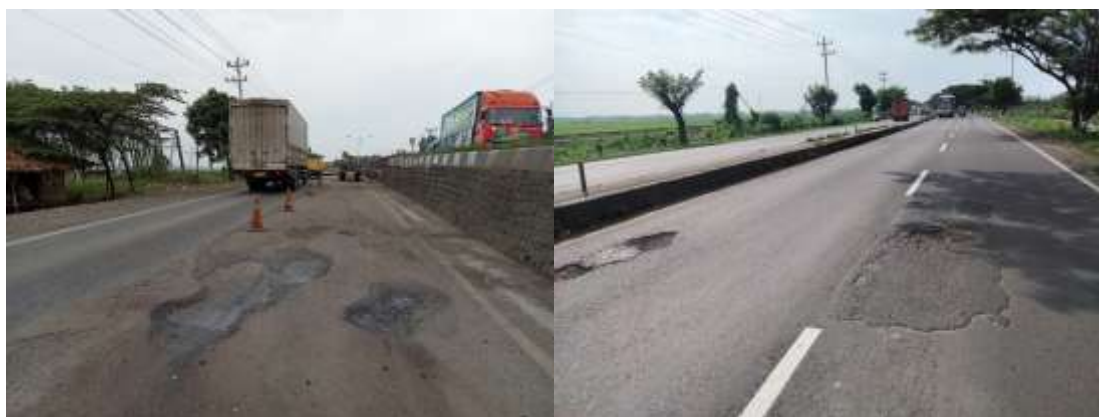
Gambar 1. Dokumentasi Kerusakan Jalan
