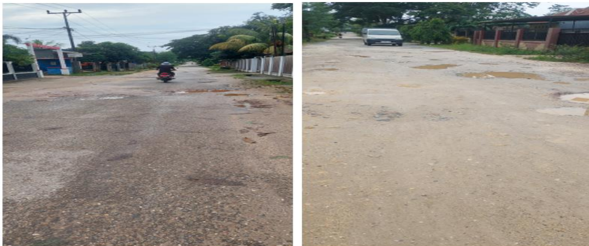
Gambar 3. Kondisi Kerusakan Jalan di Ruas Jalan Belimbing Kota Kendari (2024)
