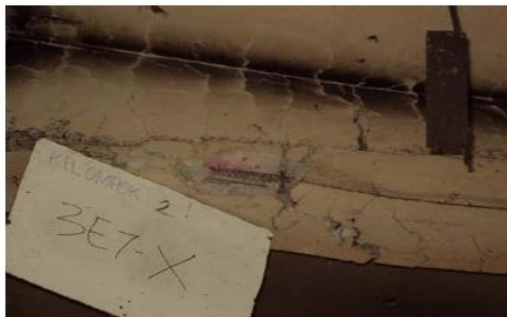
Gambar 1. Kerusakan Elemen Struktur Beton Pasca Bakar
