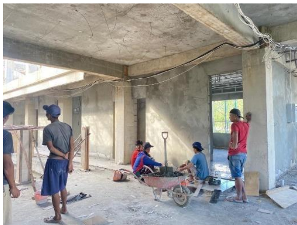
Gambar 3. Terlihat adanya Beberapa tukang atau Pekerja yang sedang melakukan diskusi di jam kerja (Sumber : Dokumentasi Lapangan, 2023)
